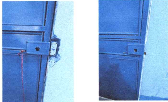
Foto 4: Sustrucción de chapa
